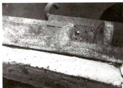
图6 浇包浇筑件与钢结构宽缝隙
