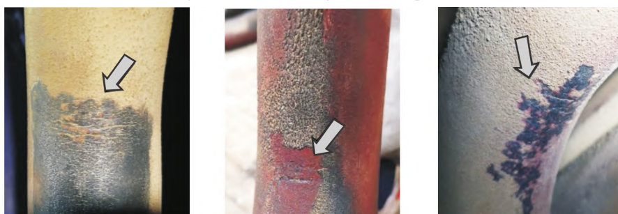
图 2 其它小屏弯管内弧面损伤
